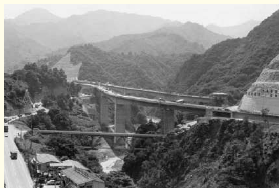
現在の甲州市大和町にある中央自動車道「日川高架橋」の工事の様子
